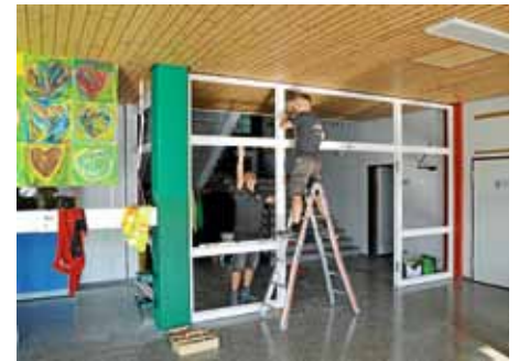
Brandschutz im Schulgebäude.
